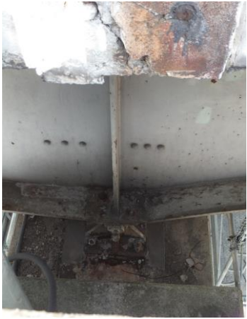
図-15 支点上の縁石 が崩壊
